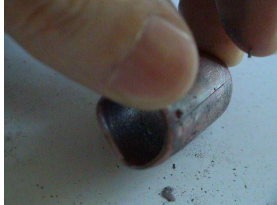
Azot altında kaynak yapılmamış bakır boru
