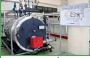
Buhar Kazanı Ünitesi
