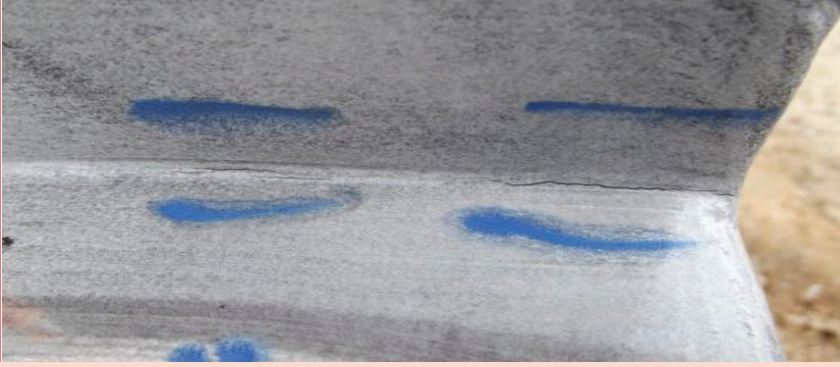
Fotograf 12. Gerilmenin Yüksek Olduğu Bölgede Bulunan Çatlak
