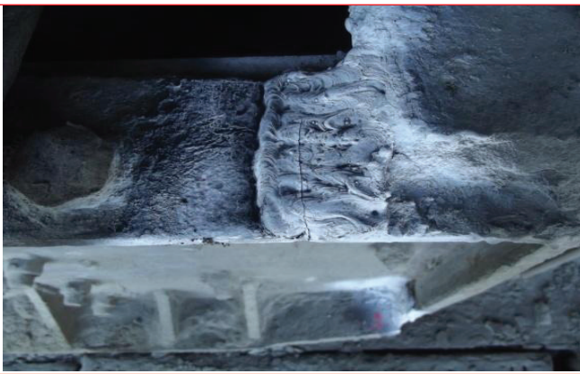
Fotograf 5. Uygun Yapılmayan Tadilat Sonrasında Tekrar Oluşan Çatlak
