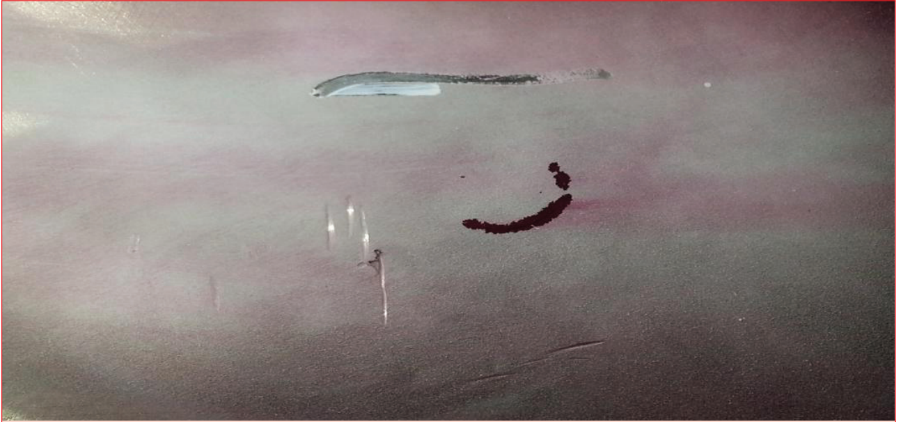
Fotograf 9. Darbe Alan ve Bakımı Yapılan Paslanmaz Fikse Kazanında Penetrant Testi ile Tespit Edilen Çatlak
