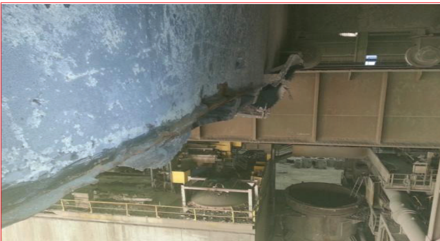
Fotograf 18. Isı Tesiri Altında Çalışan Vinçte Meydana Gelen ve Gözle Görülebilen Plastik Deformasyonlar
