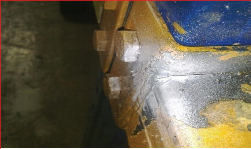
Fotograf 17. Yanlış Yapılan Kaynak Uygulaması Sonucunda Meydana Gelen Çatlak
