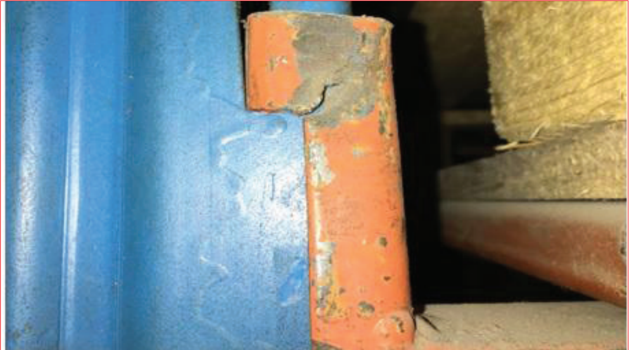
Fotograf 7. Gözle Muayene Sonucunda Tespit Edilen Plastik Deformasyon ve Çatlak
