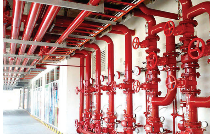
Trafolarda Kullanılan Yangın Söndürme Sistemleri
