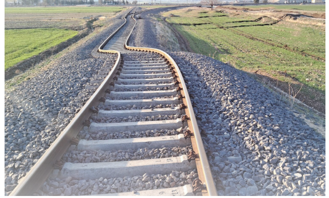
Deprem Sonrası Kırsal Bölgelerde Gözlemler ve Yeni Yapılanmada Dikkate Alınması Gerekenler
