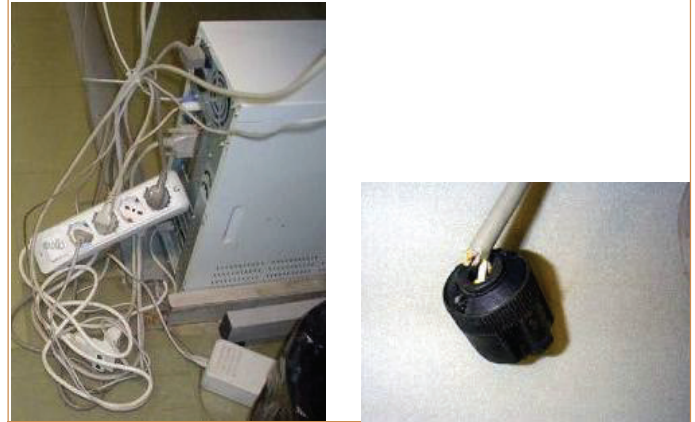
Şekil 3. Yangın Kaynağı Olabilecek Uzatma Kabloları, Çoklu Prizler ve Uygunsuz Kablo Bağlantıları
