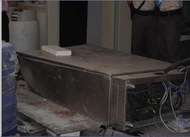
Fotoğraf 12. Devrilen Elektrik Panosu
