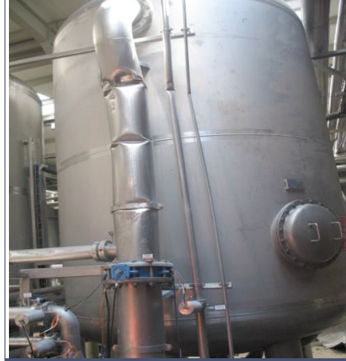
Fotoğraf 13. Tesisat Boruları
