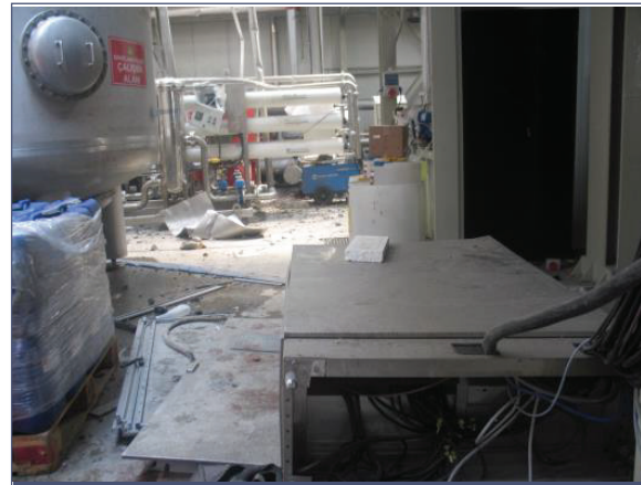
Fotoğraf 15. Kazan Dairesinde Oluşan Hasarlar
