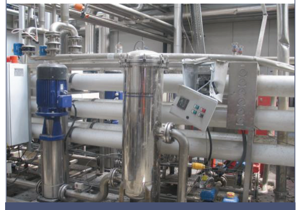
Fotoğraf 14. Su Arıtma Cihazındaki Hasar
