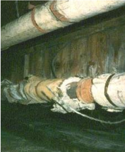
Boru izolasyonunda kullanılan asbest
