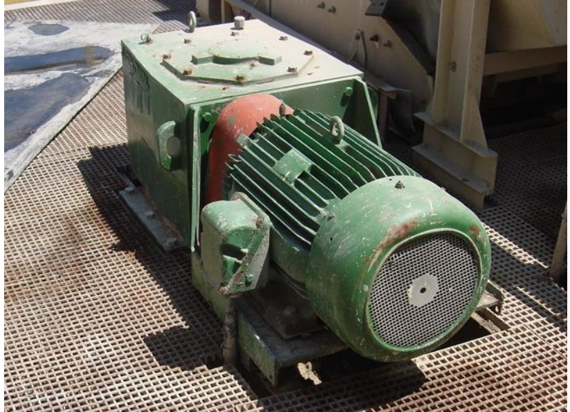
Resim 1. Tank Karıştırıcısı Elektrik Motoru
