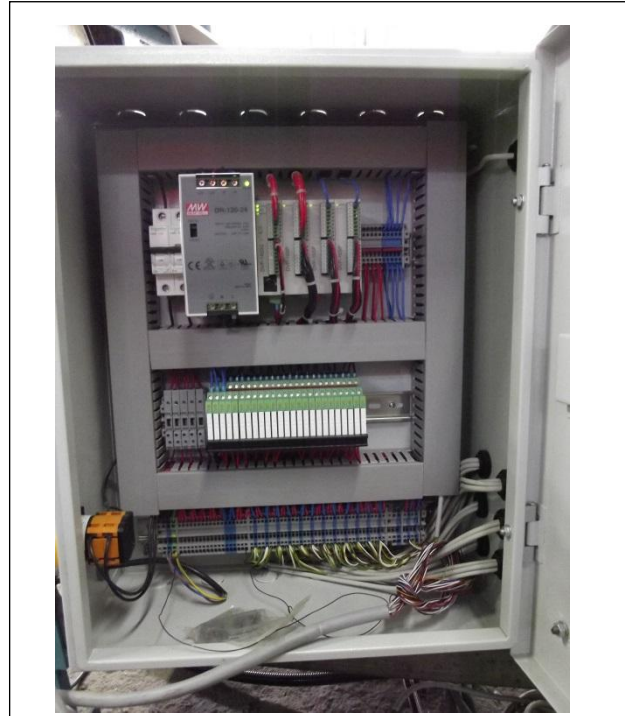
Şekil 1. Elektrik-Elektronik Kontrol Panosu [10]
