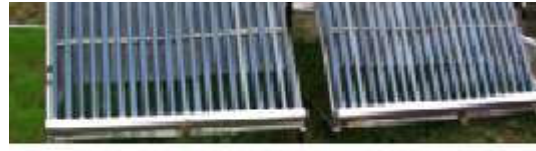
Şekil 2. Isı toplama ünitesi.
